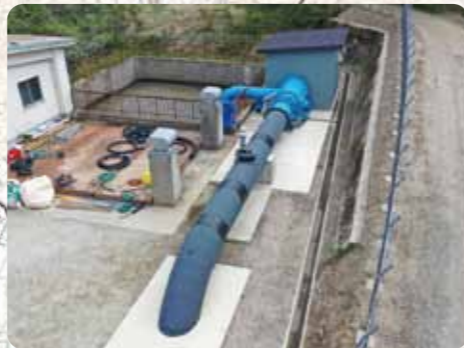
新庄 小水力発電所
