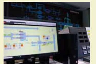
新松本、上金沢、下金沢への消流雪用水遠隔操作
