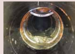
①排泥管:漏水状況
