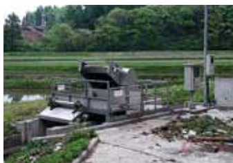
福宮用水路除塵機のゴミ
