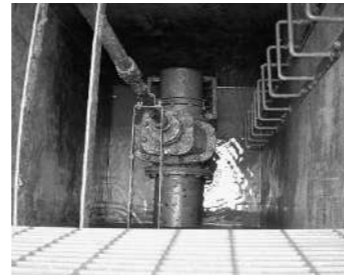
排泥バルブ更新前
