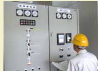
清水揚水機場電気点検
