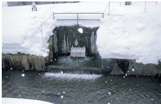
中の川への放水(7-2分水工)
