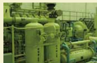
3号ポンプ点検(1)
