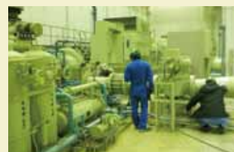
3号ポンプ点検(2)
